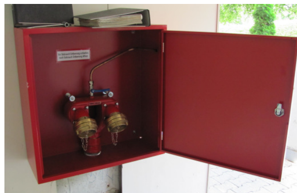
Abb. 7: Einspeisestelle mit Schutzschrank für Löschwasseranlagen „trocken“.
