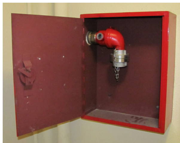
Abb. 8: Entnahmestelle mit Schutzschrank für Löschwasseranlagen „trocken“.
